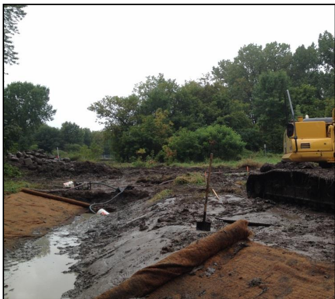
Photo 11. Pompe qui évacuait l'eau
